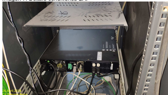
Imagen 7: Detalle conexiones SAI
