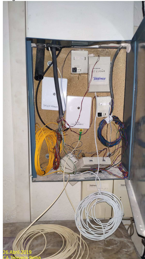
Imagen 5: Detalle cofre comunicaciones
