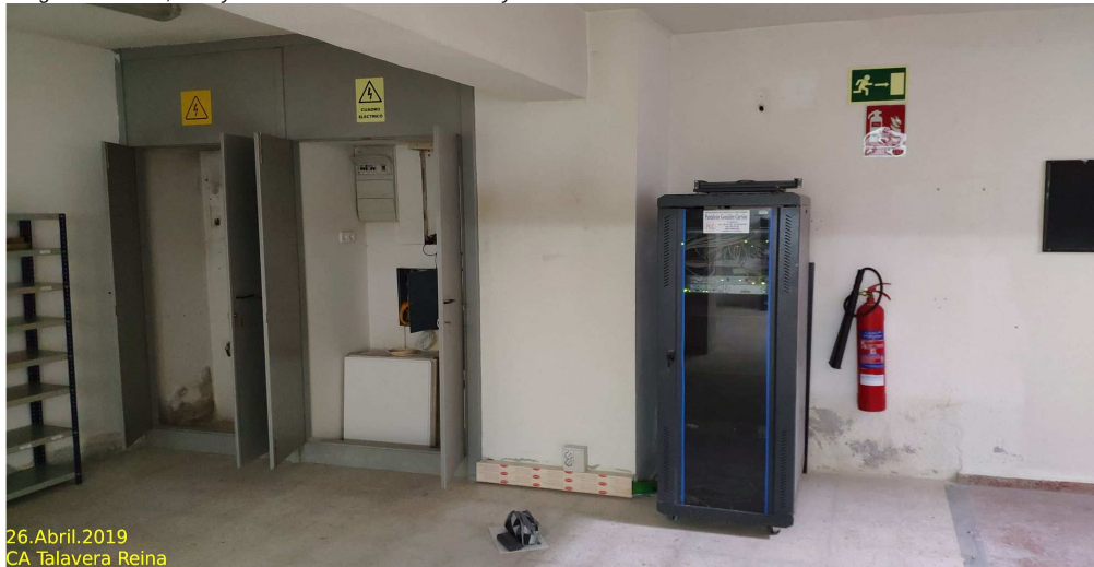
Imagen 3: Sótano, rack y armarios de comunicaciones y electricidad.
